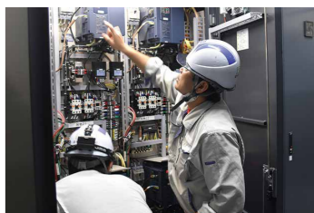
吊物機構の心臓部とも言える制御盤を点検するスタッフ
