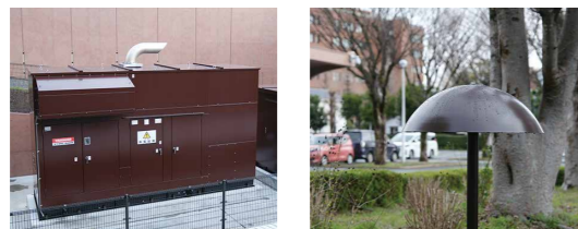
大型の非常用発電機を撤入口そばに新たに移設しました。屋外の照明器具を更新しました。
