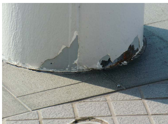
正面玄関柱塗装剥離
