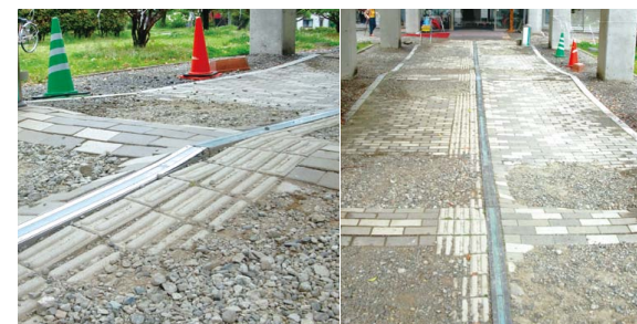
正面玄関のアプローチ陥没
