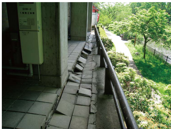
会館北側擁壁陥没
