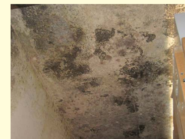
天井に発生したカビ
