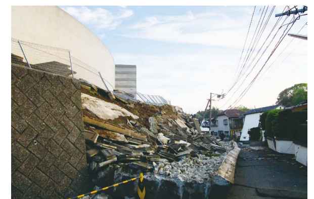
建物裏の倒壊した擁壁(下から)
