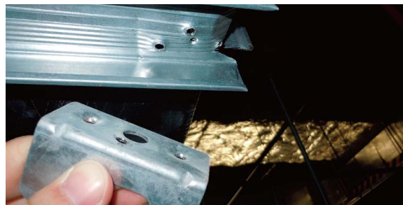
天井裏の金具の破損
