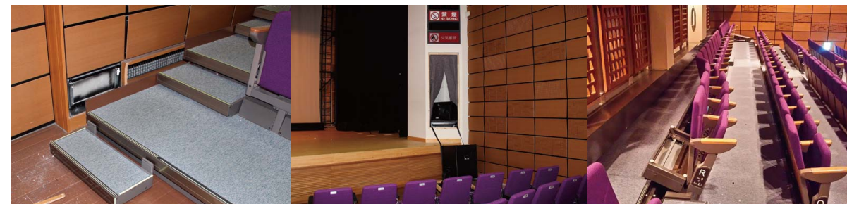
側面パネル落下
