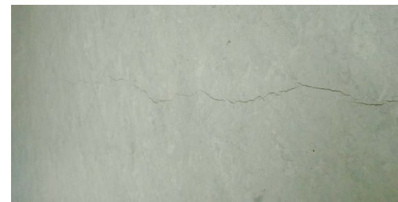
ロビー床ひび割れ
