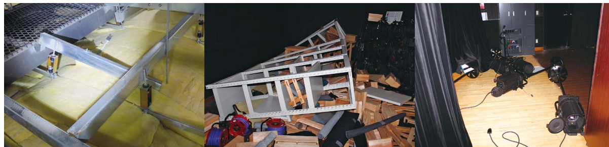
天井裏 吊り金具の損傷
