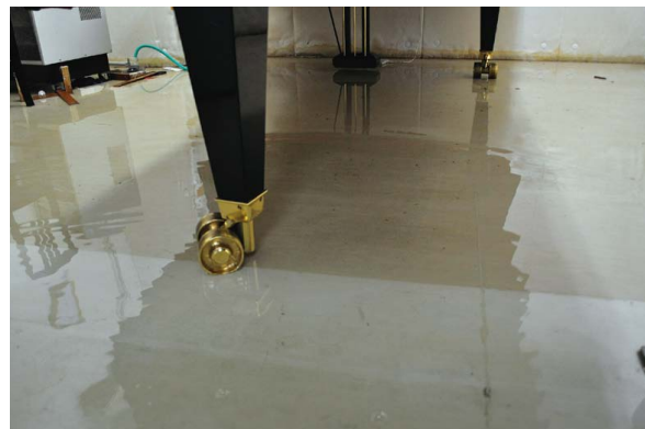
深さ1～2cm浸水したピアノ庫
