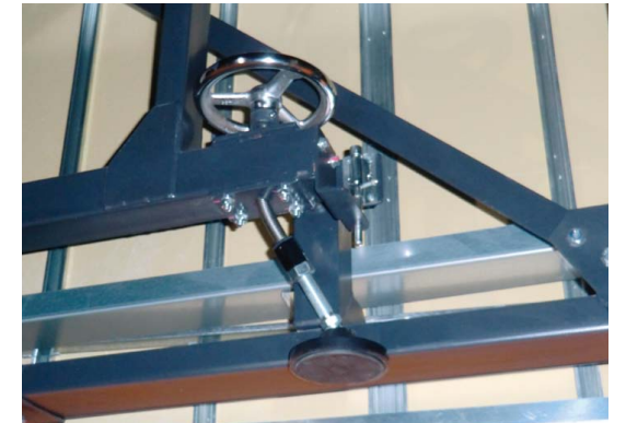
音響反射板サポートジャッキ破損
