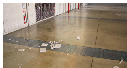
前震による展示ホール内の被害
