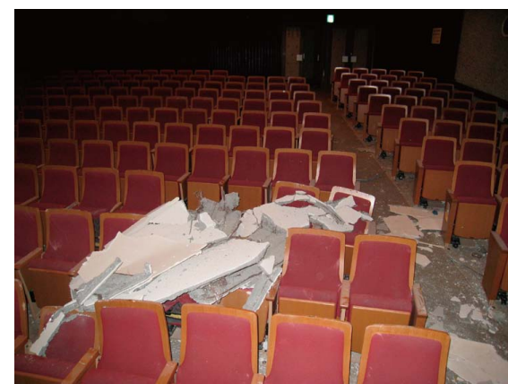
大ホール1階客席破損
