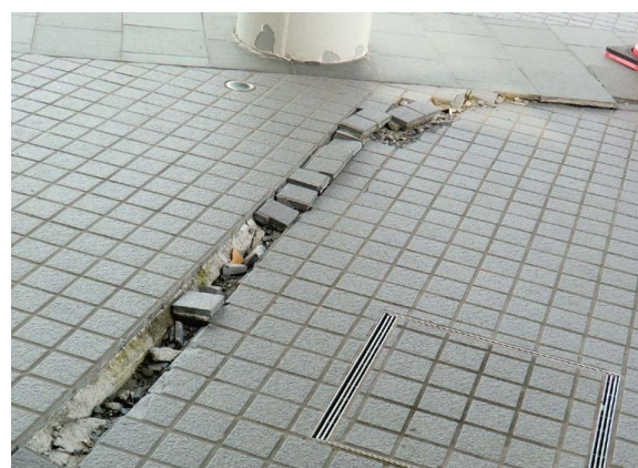
正面玄関アプローチ破損
