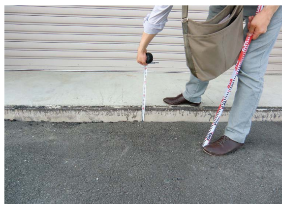
南側大道具搬入口沈降
