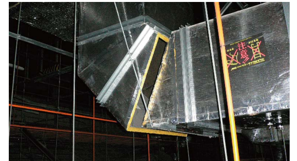
空調ダクト外れ
