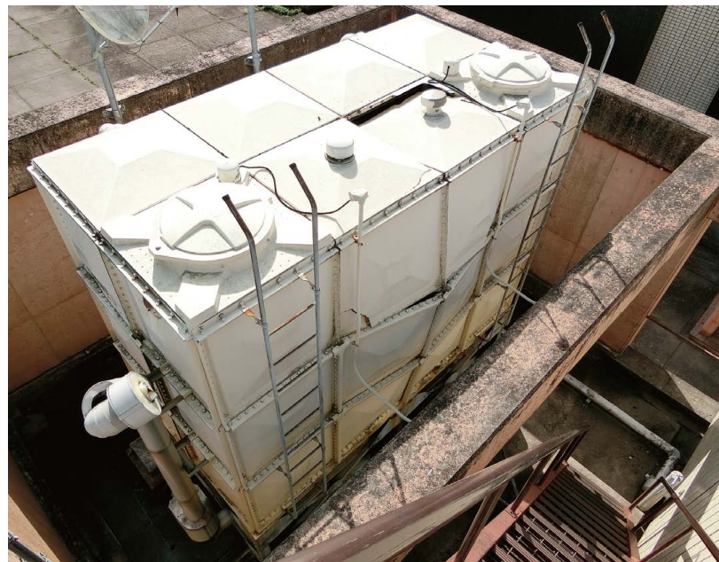
屋上高架水槽の破損
