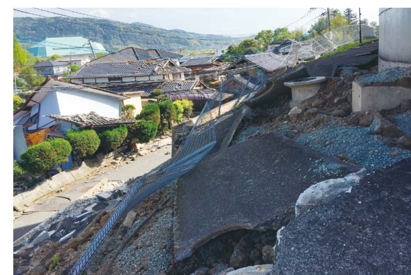
建物裏の倒壊した擁壁(上から)
