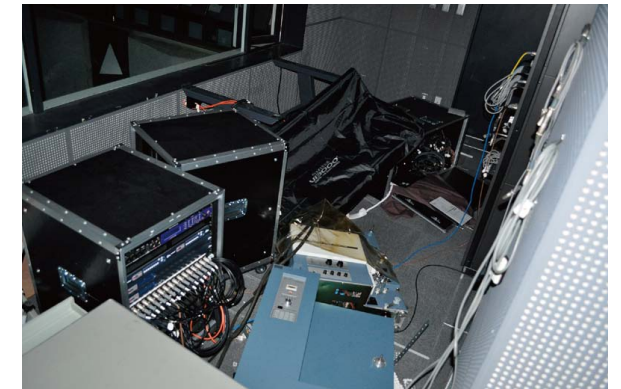
音響室の落下した音響卓
