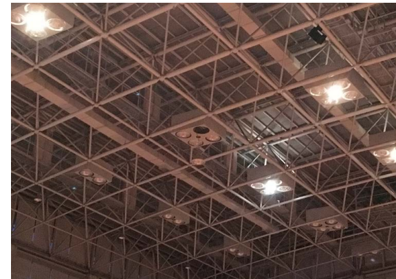
メインアリーナの照明の電球割れ
