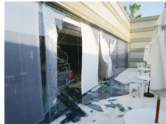
ロビー側テラスのガラス粉碎
