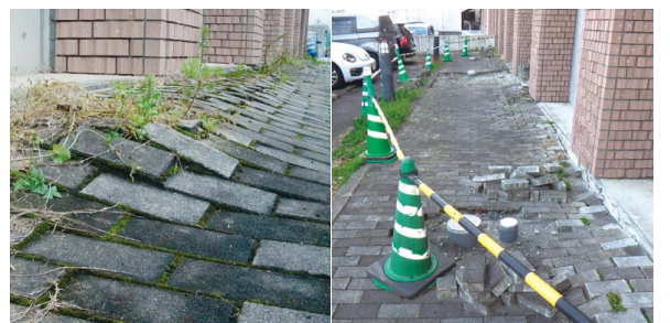
屋外通路陥没
