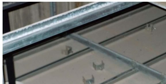
吊り天井ジョイント金具の落下
