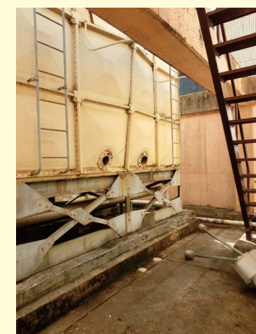
高架水槽の破損
