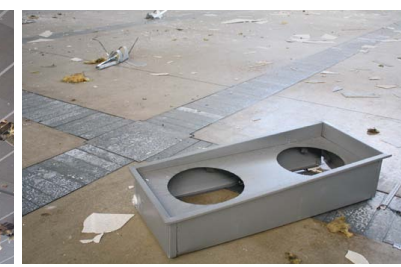
1階展示ホールに落下した水銀灯カバー
