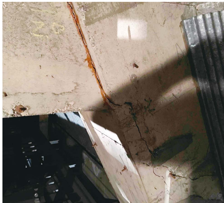
すのこ梁クラック
