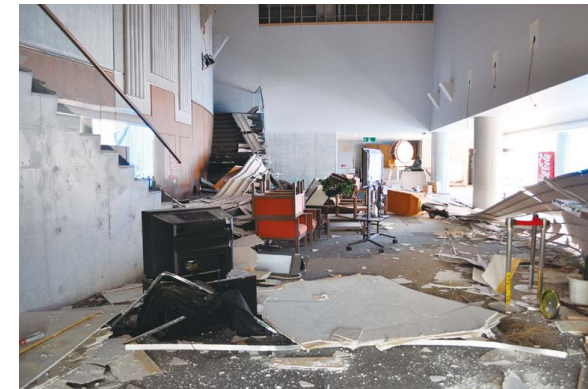
ロビー天井の一部崩落
