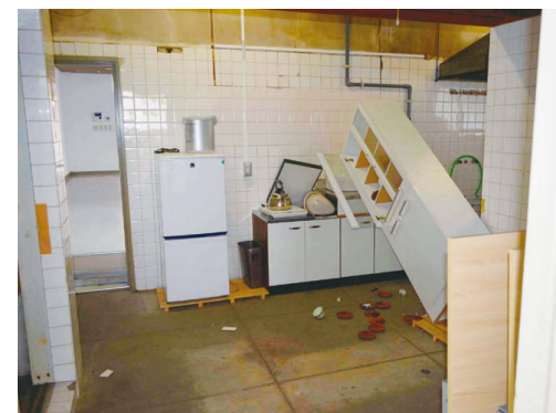
ギャラリー壁面ひび・タイル落下
