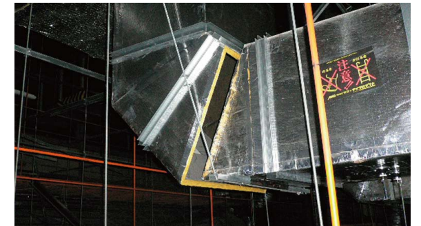
空調ダクト外れ
