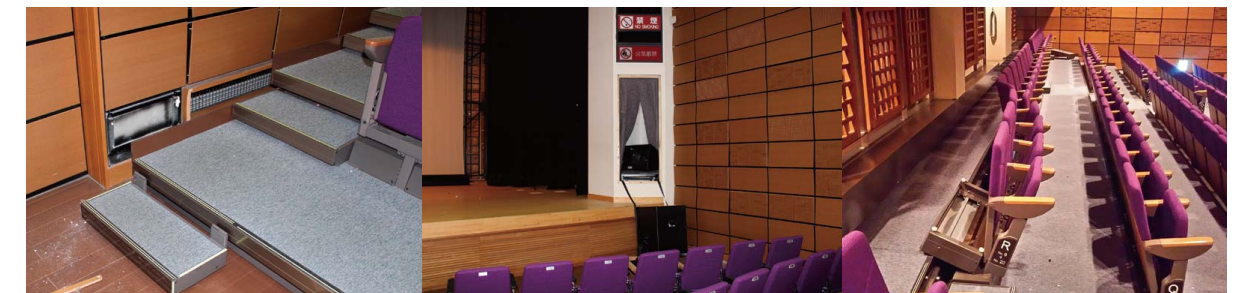
側面パネル落下
