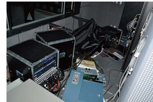
音響室の落下した音響卓
