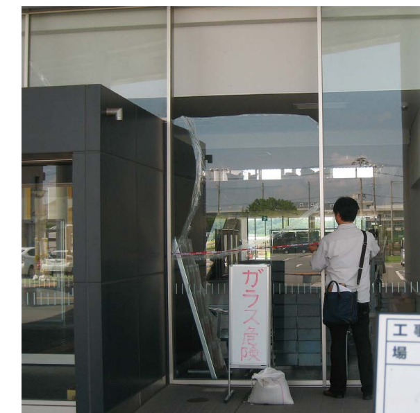
北側エントランスホールガラス破損
