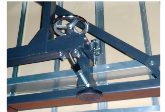
音響反射板サポートジャッキ破損
