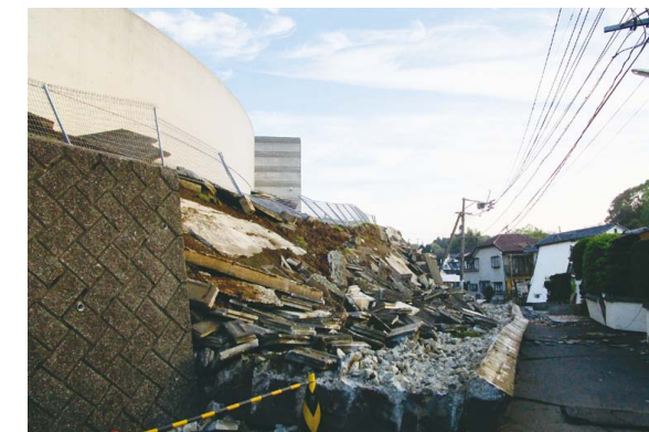
建物裏の倒壊した擁壁(下から)
