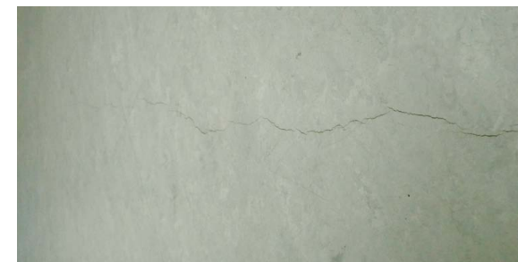
ロビー床ひび割れ
