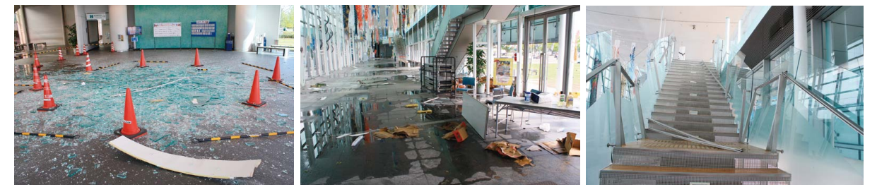
2階レストランから中央エントランスへ割れ落ちたガラス
