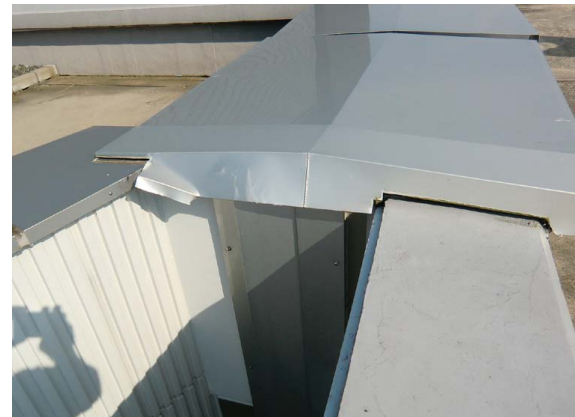
屋上エクステンションジョイント破損
