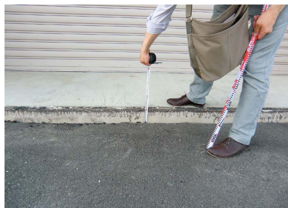
南側大道具搬入口沈降
