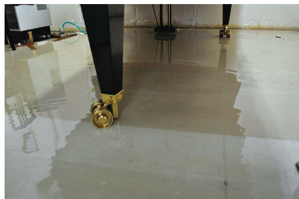
深さ1~2cm浸水したピアノ庫
