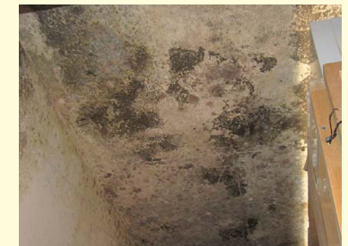
天井に発生したカビ
