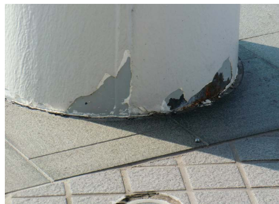
正面玄関柱塗装剥離
