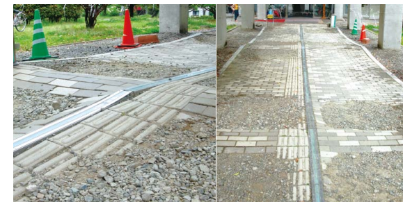
正面玄関のアプローチ陥没
