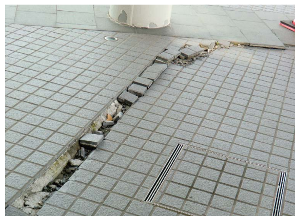
正面玄関アプローチ破損
