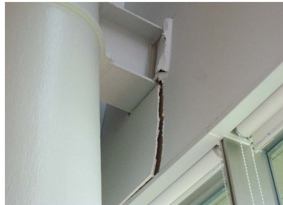
図書室壁ひび割れ
