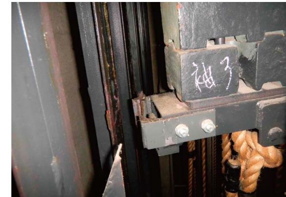
ガイドシュー変形破損
