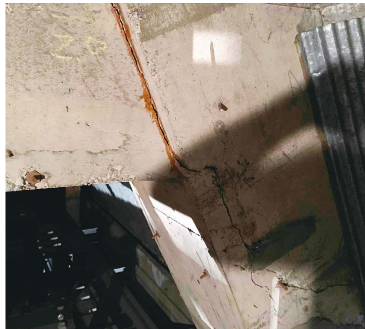
すのこ梁クラック
