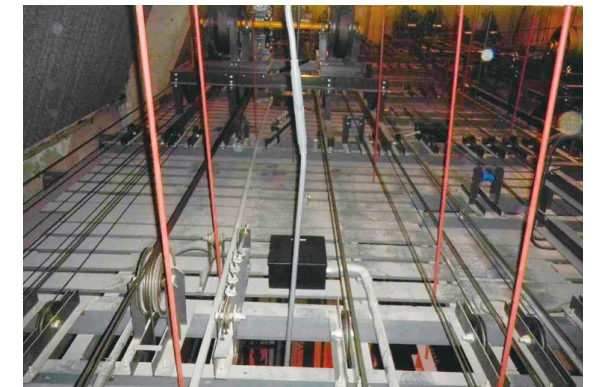
すのこ吊りボルト変形
