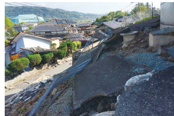
建物裏の倒壊した擁壁(上から)
