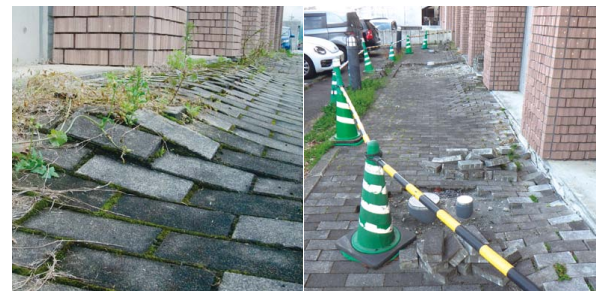
屋外通路陥没
