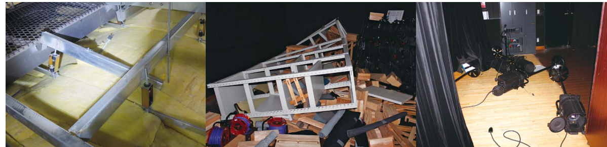
天井裏 吊り金具の損傷
