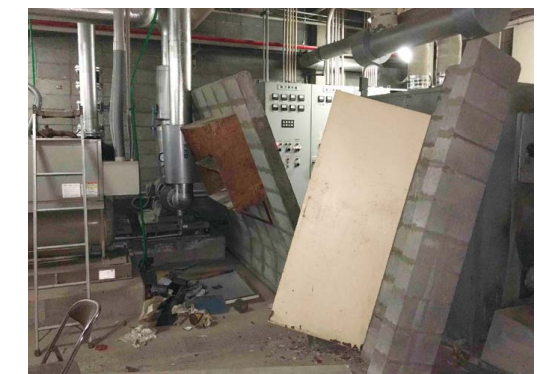
ボイラー室の防火壁(ブロック塀)倒壊
