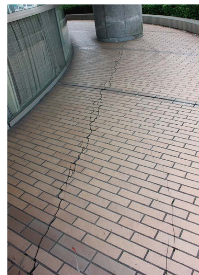
タイルに亀裂が入った玄関前
