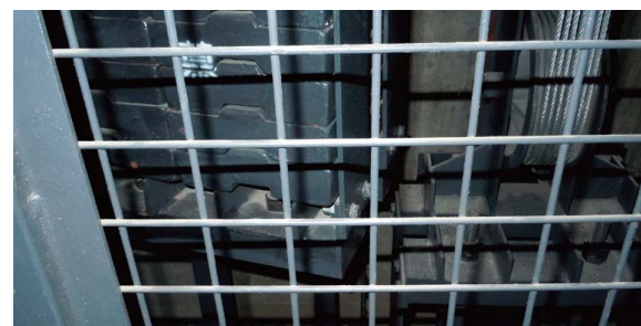
ガイドレールから外れた吊物ウェイト
