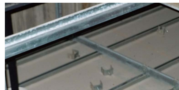
吊り天井ジョイント金具の落下
