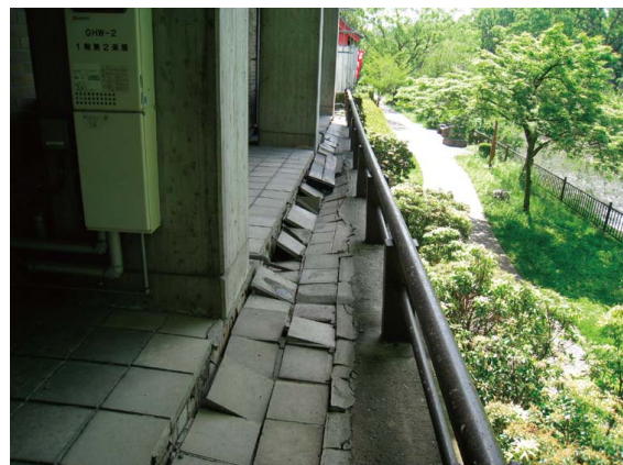
会館北側擁壁陥没
