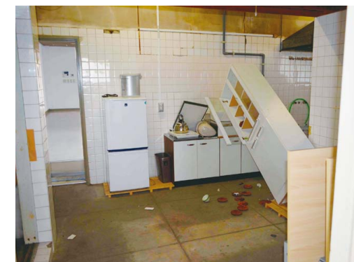
ギャラリー壁面ひび・タイル落下
