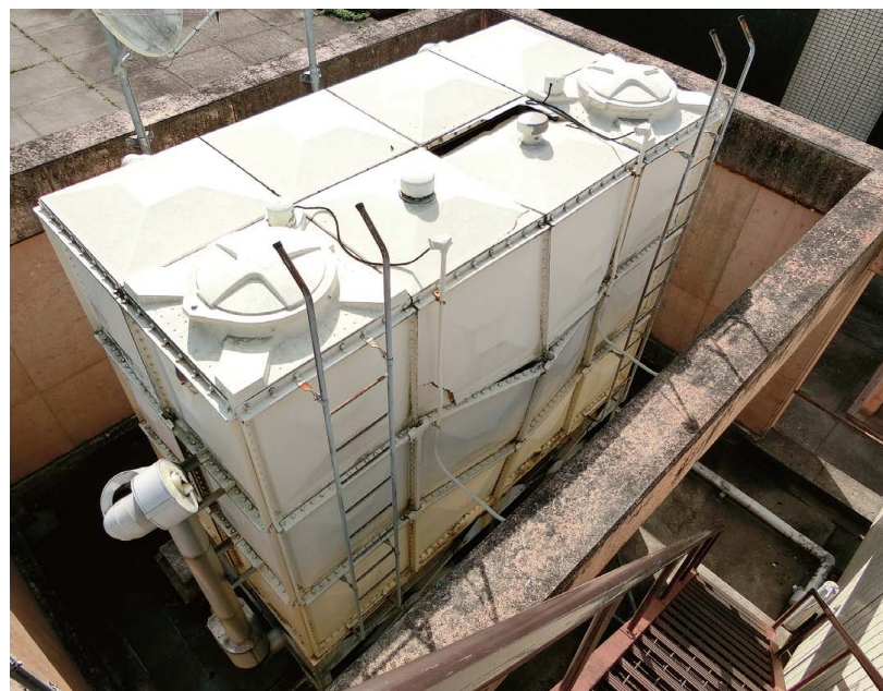
屋上高架水槽の破損
