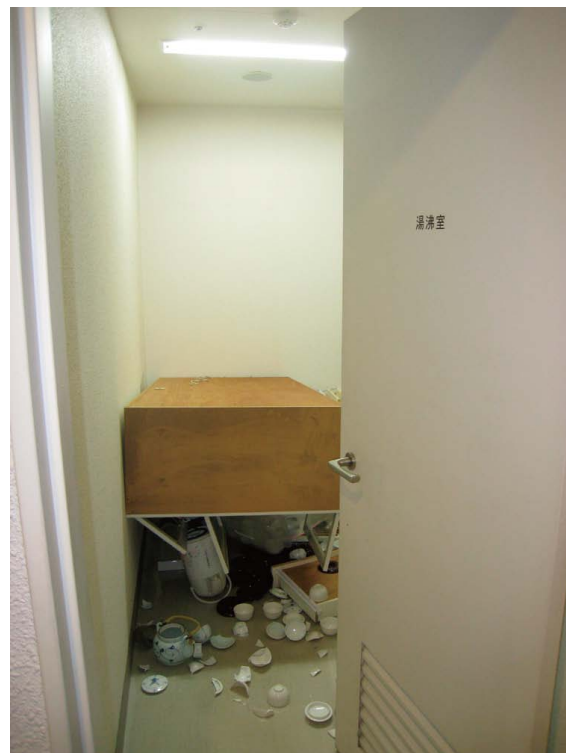
会議棟中2階湯沸室食器棚転倒
