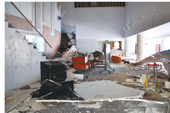
ロビー天井の一部崩落
