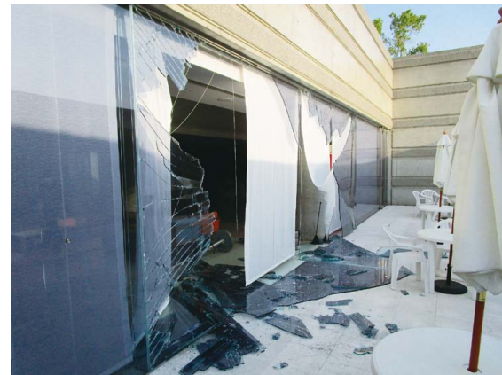
ロビー側テラスのガラス粉碎
