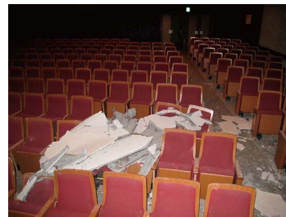
大ホール1階客席破損
